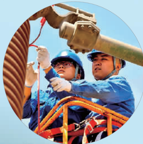
◆18日,乌海市最高温度达39℃,为保证电网安全可靠运行,乌海供电公司变电检修人员正在祥和220千伏变电站内开展设备综合检修工作。
