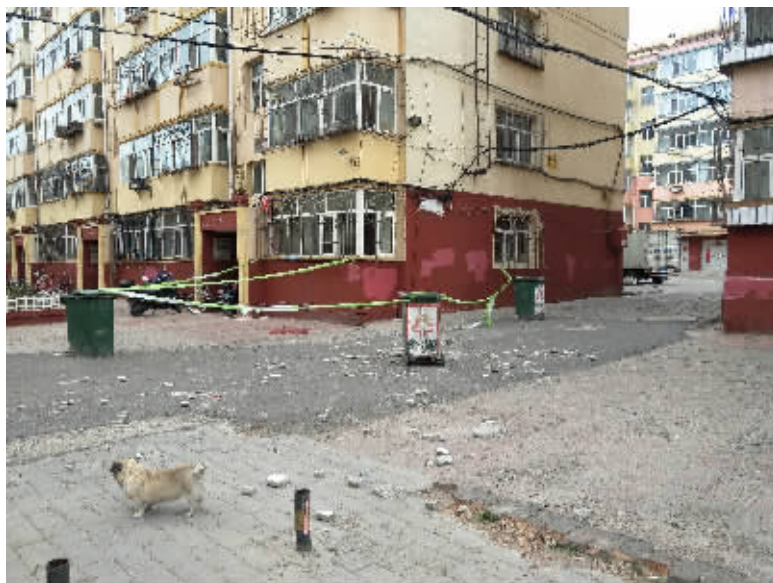
◆脱落满地的石灰块
