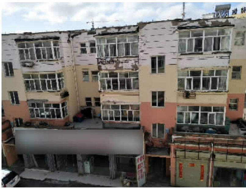
◆集宁区神州家园小区楼房外墙破损严重
